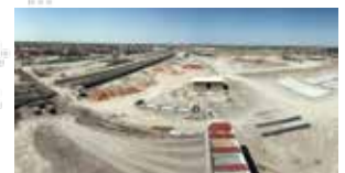
Usine d'épuration de l'eau et les canalisations de transfert de la ville Al Kif
