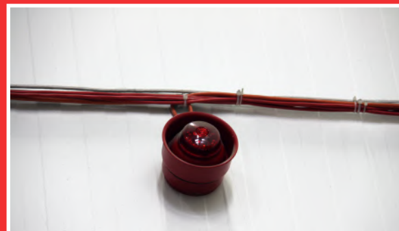
فایر آلارم (سیستم اعلان حریق)
